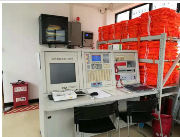
消防集控系统
